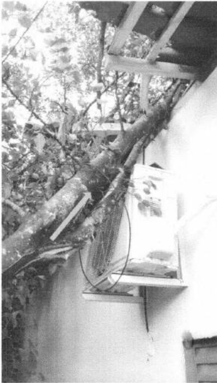
DETALHE: DANO AO AR CONDICIONADO.
